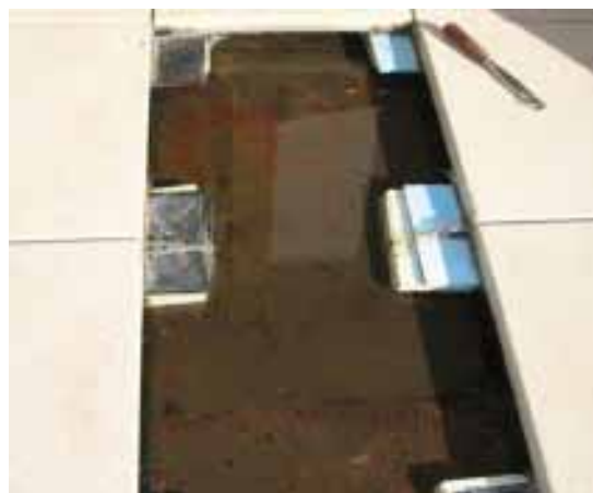
Eau stagnante sous toiture praticable
